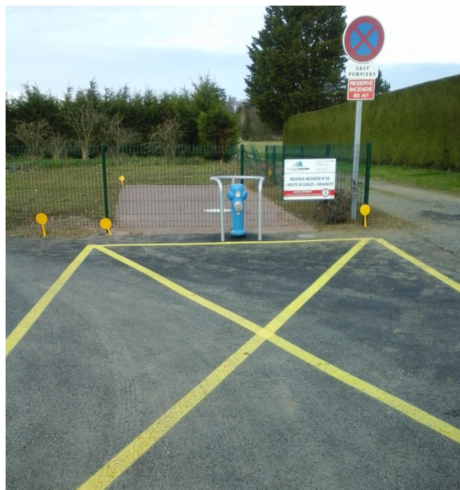
Installation d'une bête à incendie à la Mauvielle
